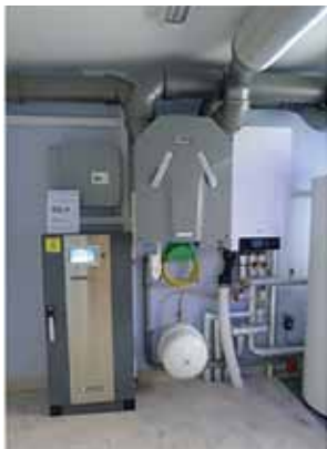
中央上:熱交換型換気扇 左:蓄電池(太陽光パネルで発電した電気を蓄電する)
